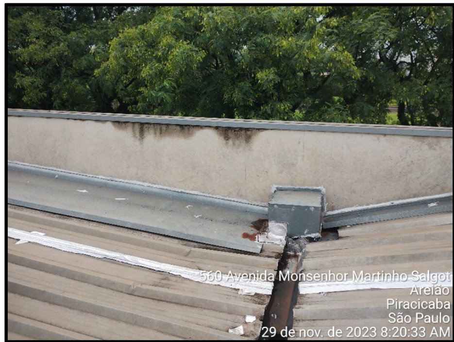
Vista dos rufos com vazamento e o transpasse incorreto
