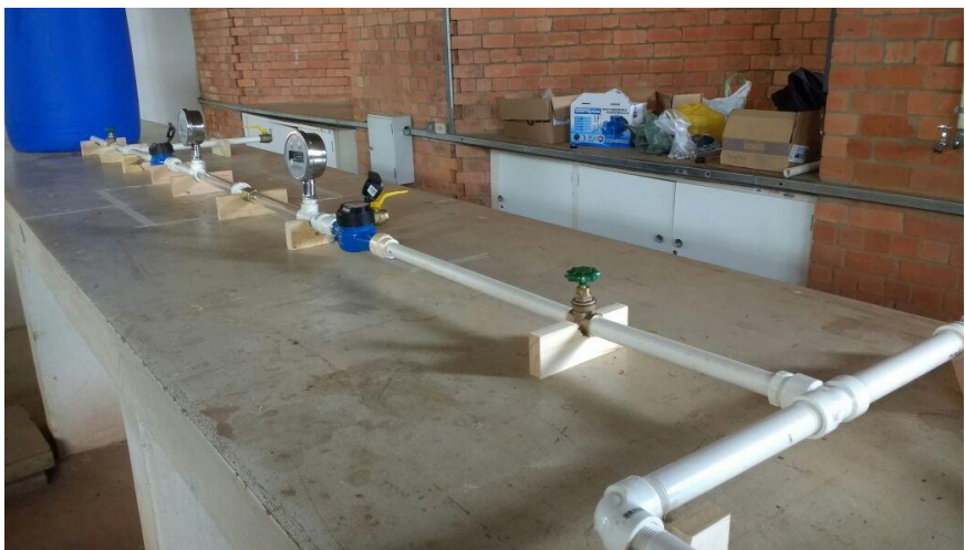
Figura 10 – Detalhe da bancada após a ramificação.
