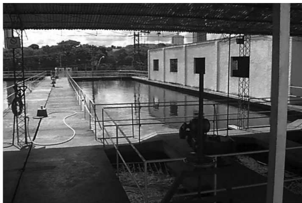
Fotografia 6 - Vista de um dos floculadores e decantadores da ETA II
