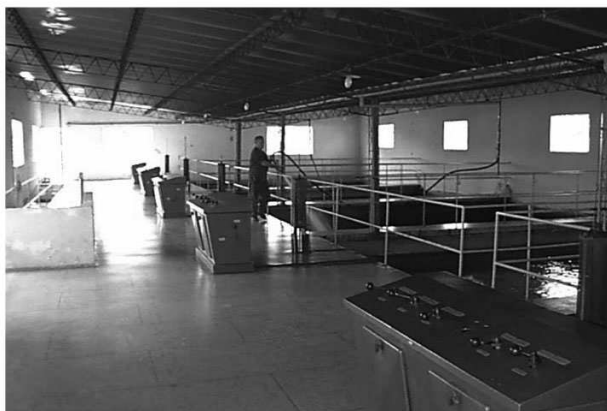
Fotografia 7 - Vista geral dos filtros da ETA II 1
